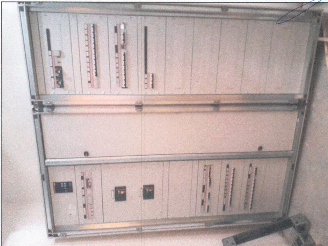
Foto 6 - Quadro elettrico cavedio
