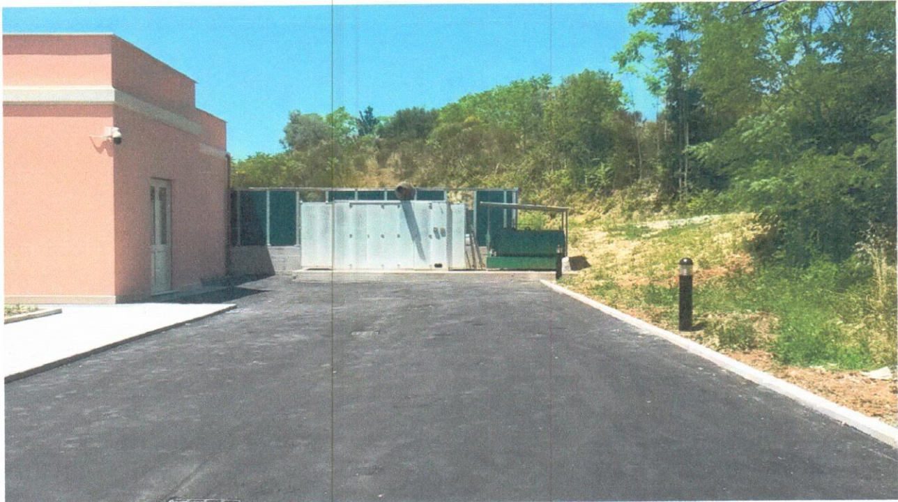
Foto 16 – Posizionamento generatore (non compreso in Appalto)
