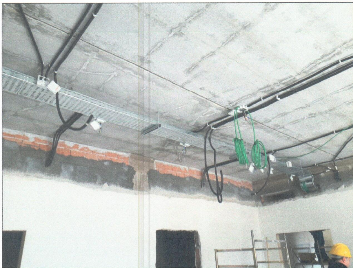
Foto 3 – Attraversamento dorsale sala comune p.t. con cavidotti e cavi + intonaco interno. In alto fascia antiribaltamento tramezzi
