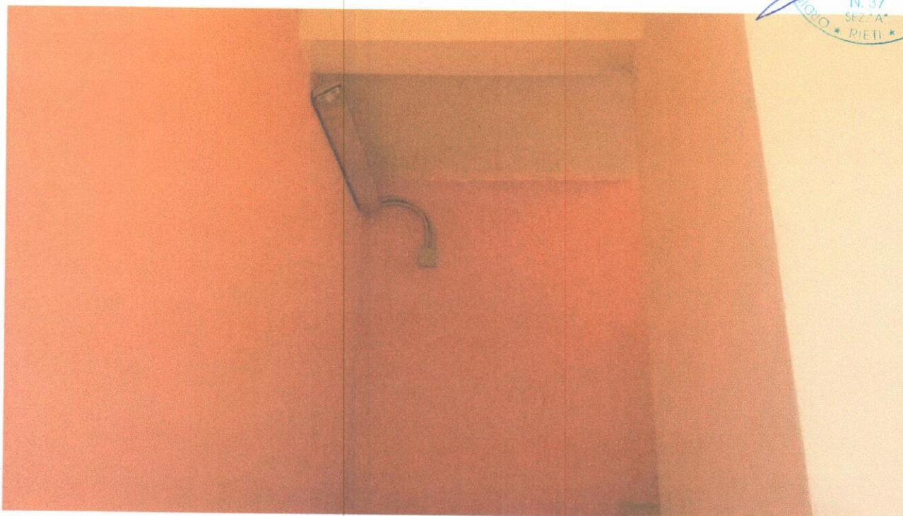
Foto 12 – Plafoniere scala oggetto di prescrizione
