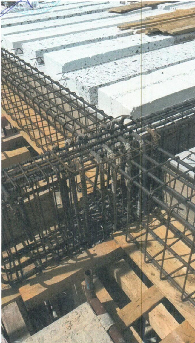
Particolare ferri di sommità pilastro tagliati oggetto di prescrizione della D.L.
