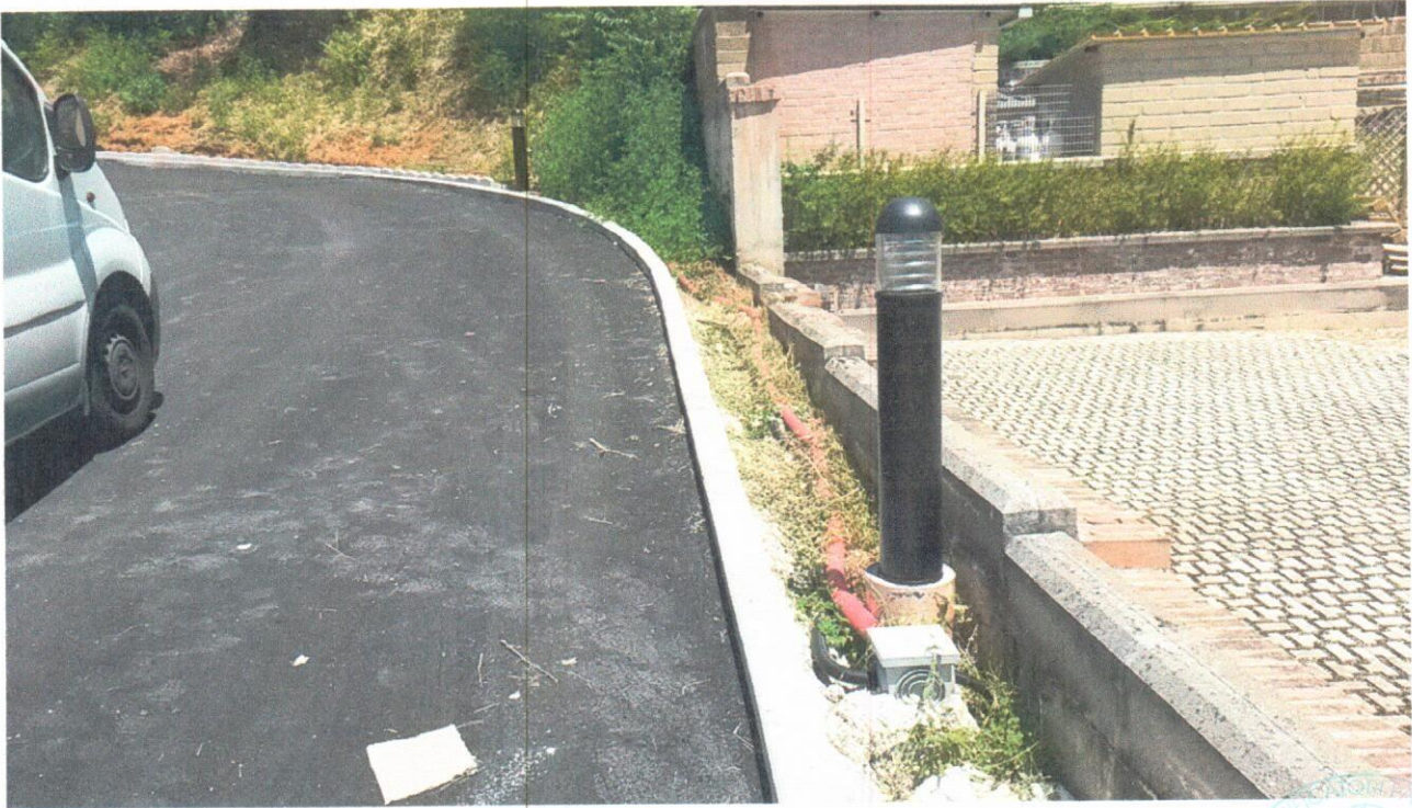
Foto 15 – Cavidotti da rinterrare
