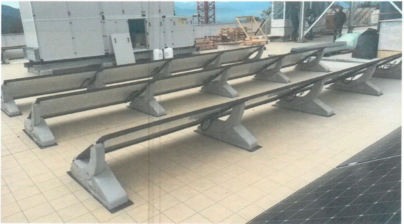
Foto 6 – Pannelli fotovoltaici copertura est e u.t.a.
