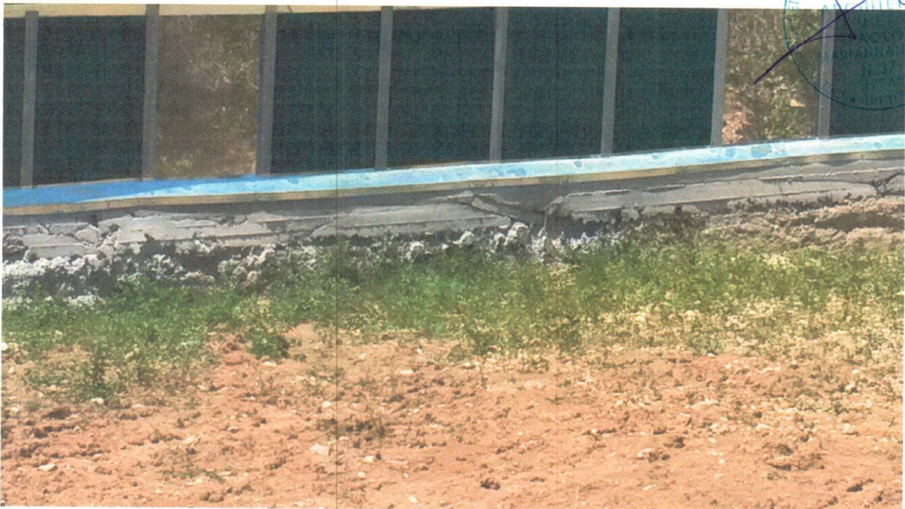
Foto 8 – Muro recinzione lato interno: fasce da rinzaffare e rifinire
