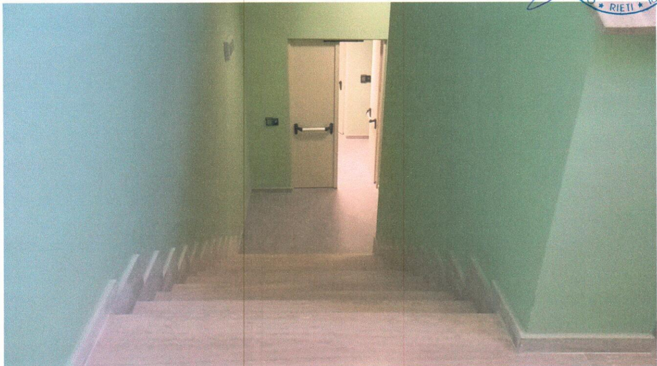
Foto 18 – Scala interna da dotare di corrimano
