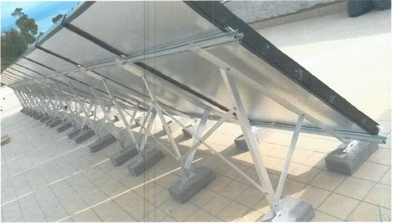
Foto 5 – Pannelli solare termico copertura ovest
